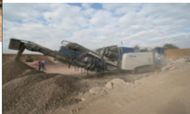
Figura 5 – Unidade de Reciclagem Júlio de Mesquita Neto: britagem dos RCC
