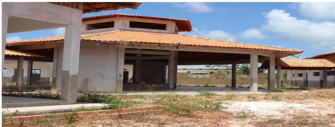
Figura 8 – Obra em situação de abandono escola Km 40 do município de São João de Pirabas, vistoriada pelo aplicativo “Tá de Pé” em novembro/2017
